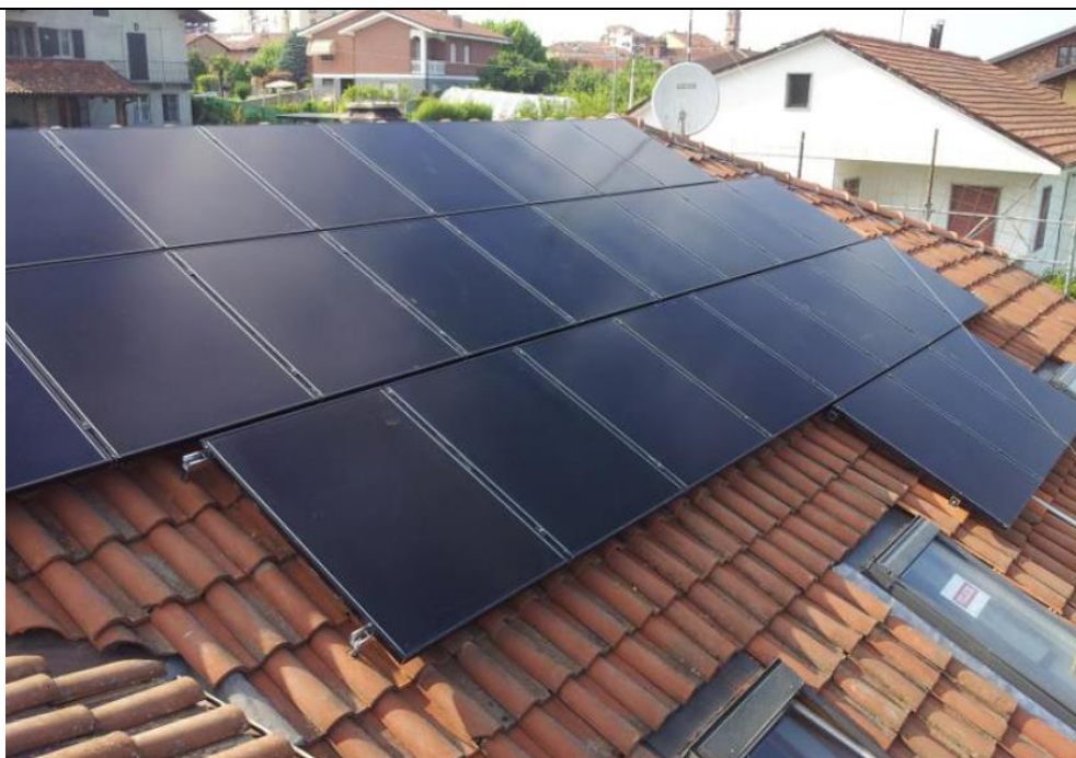
Impianto fv da 4,8 kWp, con tecnologia senza silicio, in rame-indio-selenio, realizzato nel 2014 a SAN DAMIANO D'ASTI (AT)
